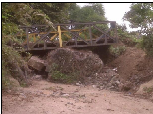
Fotografía 36 Camino de Verano mal estado
