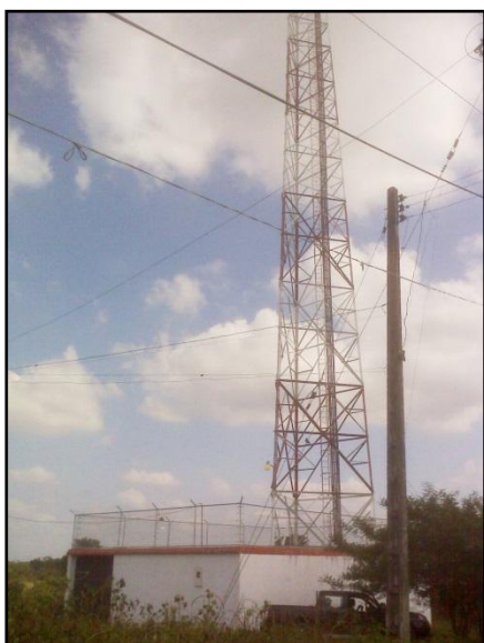
Fotografía 9 Antena de Telecomunicación PORTA
