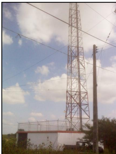
Antena de Telecomunicación PORTA
