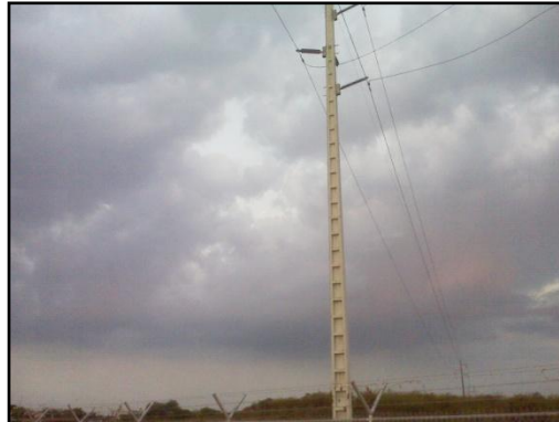
Fotografía Sublínea de Transmisión Eléctrica
