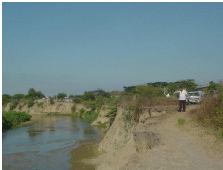
Foto 8. Meandro convexo con erosión Retrocedente activa, que afecta a camino vecinal.
