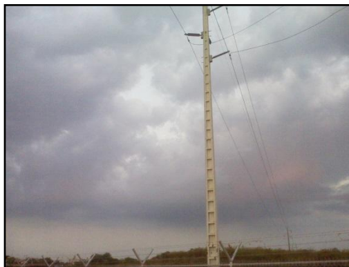
Fotografía 12 Sublínea de Transmisión Eléctrica
