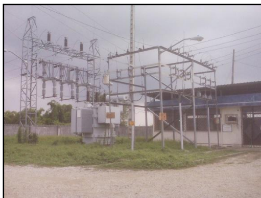
Fotografía 11 Subestación Eléctrica "Pedro Carbo"
