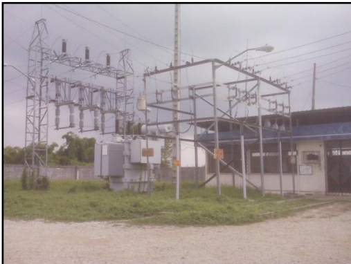
Fotografía Subestación Eléctrica "Pedro Carbo"
